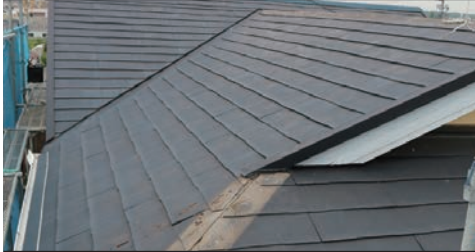
経年劣化で割れ・変色してしまった屋根でも
